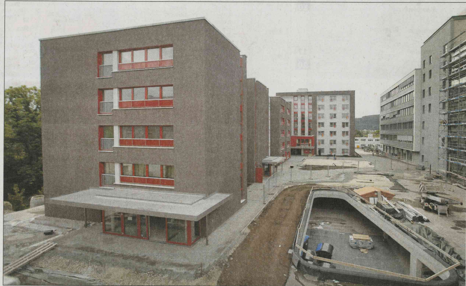
Zwölf Millionen Euro haben die Esslinger Wohnungsbaugesellschaft (EWB) und ihr Partner, die Gesellschaft für nachhaltiges Bauen und Wohnen (nbw), in das Wohnheim und die Tiefgarage auf dem Hengstenberg-Areal investiert. Die Farbmischung Rot und Aubergine setzt farbliche Akzente. Foto: Bulgryn
