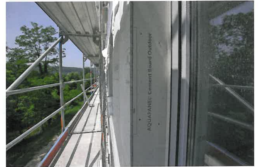
8 Außen wird die wetterbeständige und solide Zementbauplatte verschraubt. Dann kann verspachtelt und verputzt werden. (Fotos: Knauf/Heikaus)
